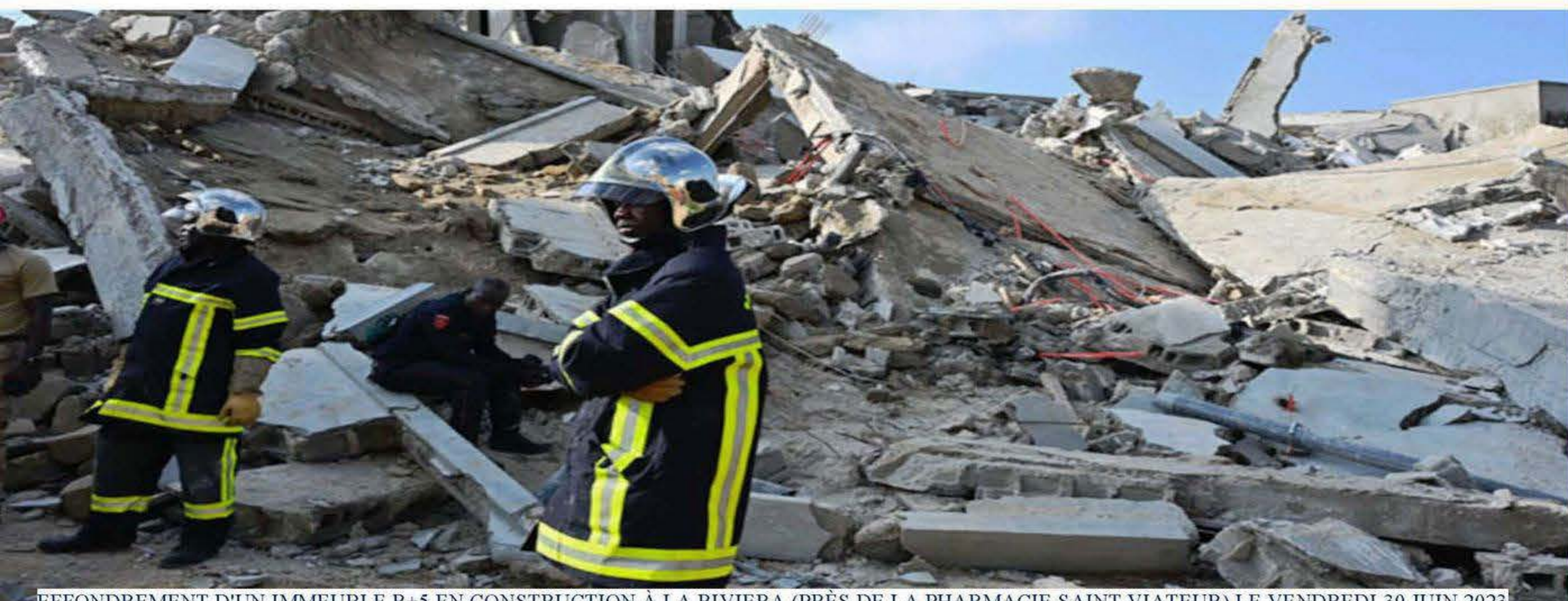
EFFONDREMENT D'UN IMMEUBLE R+5 EN CONSTRUCTION À LA RIVIERA (PRÈS DE LA PHARMACIE SAINT VIATEUR) LE VENDREDI 30 JUIN 2023
